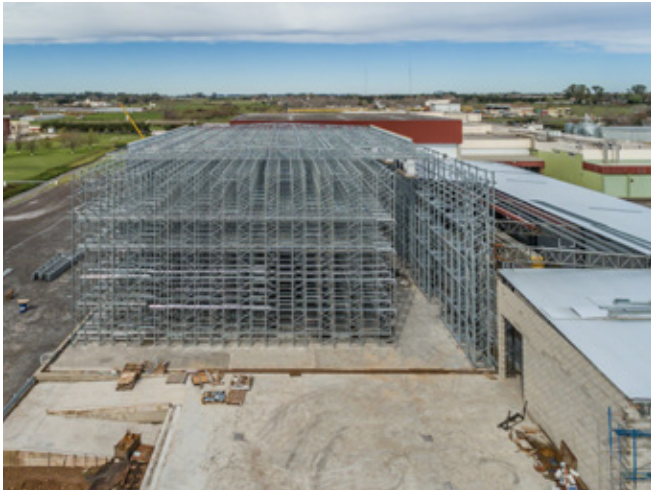
Bodega autoportante con cámara para producto congelado.
